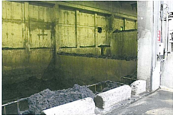
Menging en tijdelijke opslag van zuiverings-slib in bunkers met een capaciteit van 16.000 ton.
